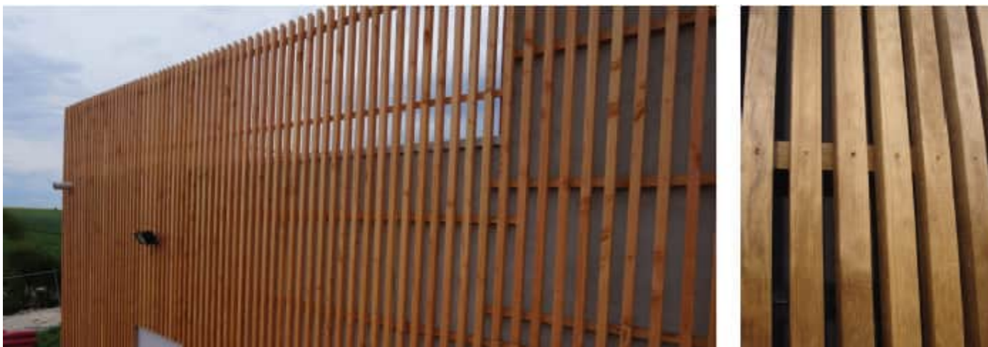
Photographie 257 : Exemple de bardage bois à claire-voie vertical garantissant l'intégration paysagère du poste de livraison tout en évitant l'installation des chiroptères attirés par le confinement.
